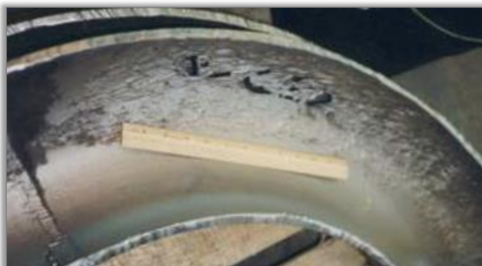
Figura 1 - tubulação danificada por corrosão naftênica
