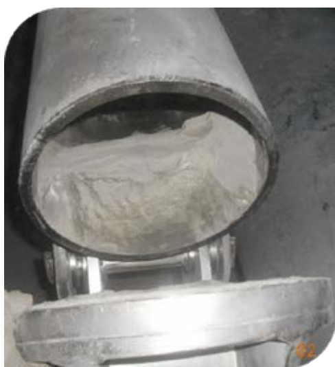
Figura 4: Formação de coque no interior da perna de ciclone. Fonte: banco de imagens FCCSA
