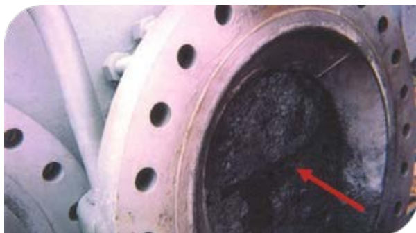
Figura 6: Deposição de coque na linha de transferência. Fonte: banco de imagens FCCSA
