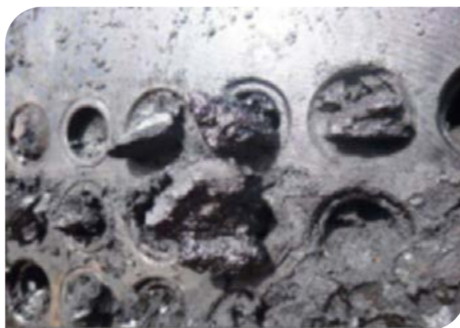
Figura 11: Obstrução de trocador de calor por coque. Fonte: Banco de imagens FCCSA
