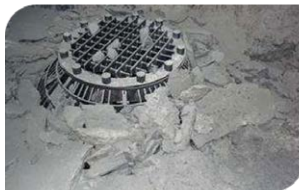
Figura 5: Coque que se desprende das paredes do reator provocando obstrução parcial da saída de catalisador. Fonte: banco de imagens FCCSA
